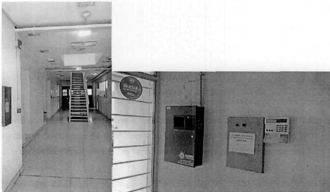
Figura 3. Sistema de Protección Contra Incendios en Edificio de Laboratorios
